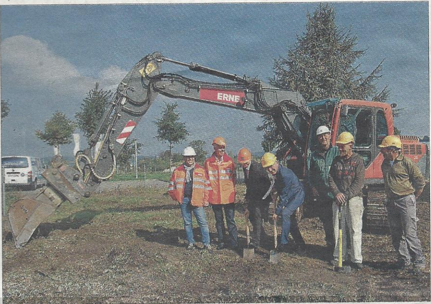
Spielplatz Spatenstich (v. l.) Baumeister Martin Burtscher und Stefan Johner, Vizedirektor, Erne Bauunternehmen AG. Vom Neuhof: Beat Thomé, Daniel Büchi, Frank Koch, Gartenbau, Patrick Gsell, Arbeitspädagoge und Hans Haller, Betriebsleiter Werkstatt für Berufsvorbereitung.
